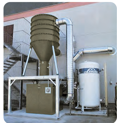
Filterzyklon auf einer Stahlkonstruktion
