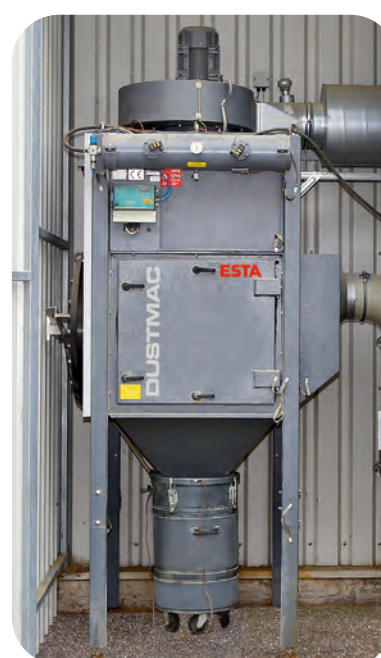
Absauganlage DUSTMAC F in der Chemie-Industrie
