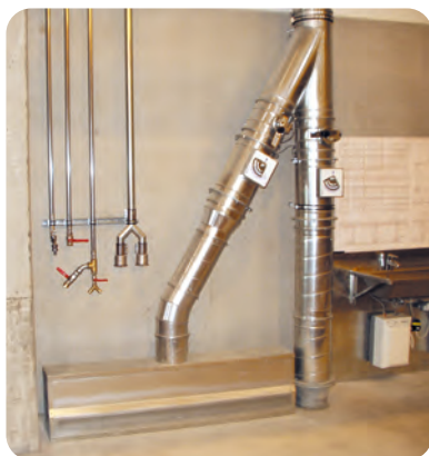
Stauberfassung durch spezielles Rohrleitungssystem
