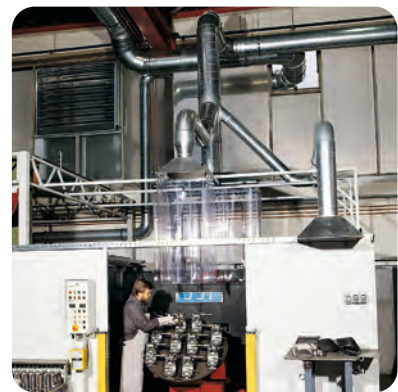
Absaugung an einem Roboterarbeitsplatz
