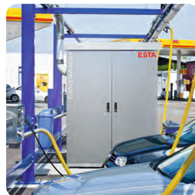
Witterungsbeständiges Gehäuse zur Außenaufstellung
