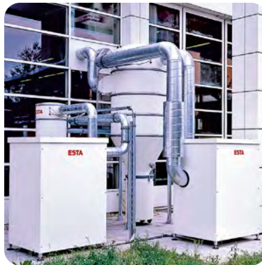
Absauganlage in Sonderlackierung im Freien aufgestellt
