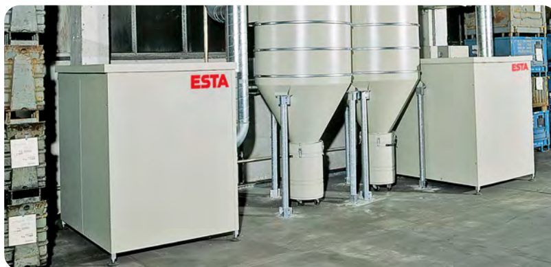
Hochdruckventilatoren in Verbindung mit zwei ESTA-Filterzyklonen
