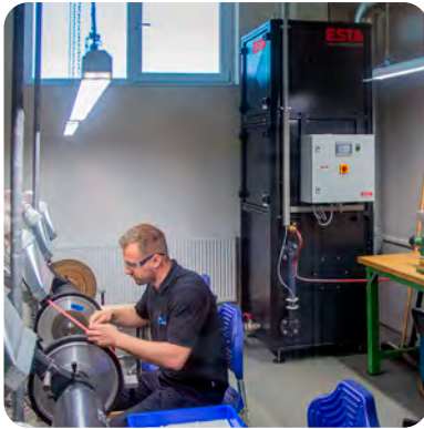
Nassabscheider DUSTOMAT HYDRO in der Schleiferei
