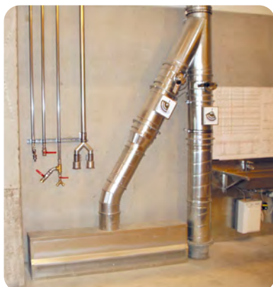
Stauberfassung durch spezielles Rohrleitungssystem
