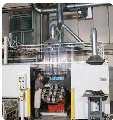
Absaugung an einem Roboterarbeitsplatz
