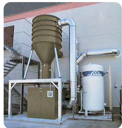
Filterzyklon auf einer Stahlkonstruktion
