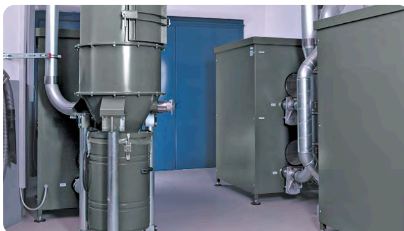
Zentrale Staubsaugereinheit mit zwei Seitenkanalverdichtern ausgestattet
