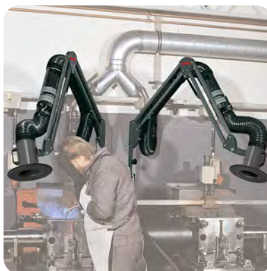
Absaugarme an einem Schweißplatz
