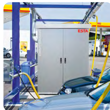
Witterungsbeständiges Gehäuse zur Außenaufstellung
