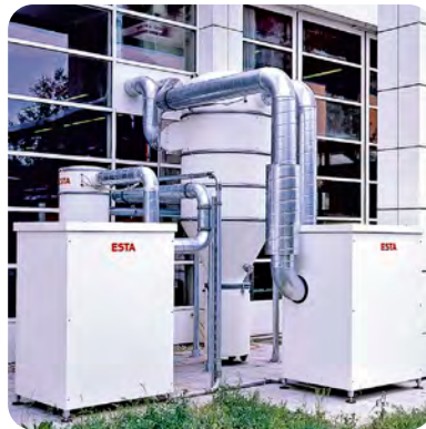
Absauganlage in Sonderlackierung im Freien aufgestellt
