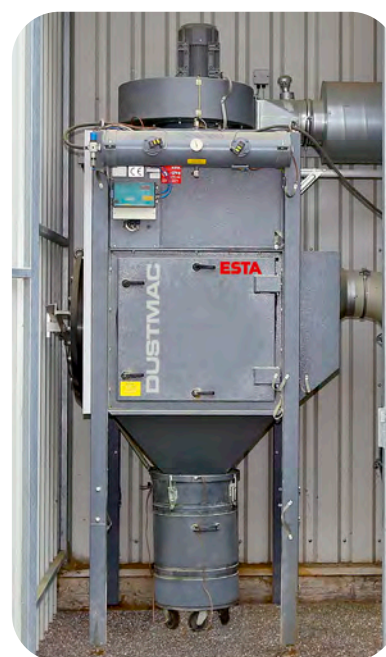
Absauganlage DUSTMAC F in der Chemie-Industrie
