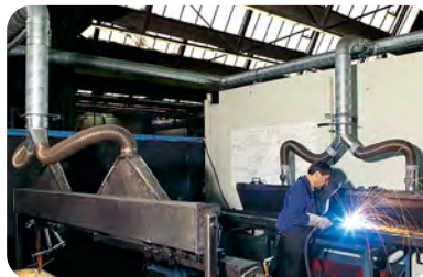
Schlitzabsaughauben im Fahrzeugbau
