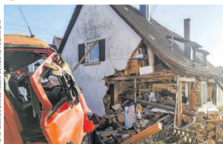
Das Haus in Stöttlen ist einsturzgefährdet.
