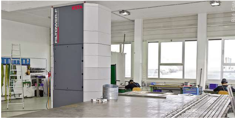
Der Filtower F-200 sorgt für saubere Hallenluft in der Schlosserei. Der Abscheidegrad der Filter beträgt mehr als 99 %.
