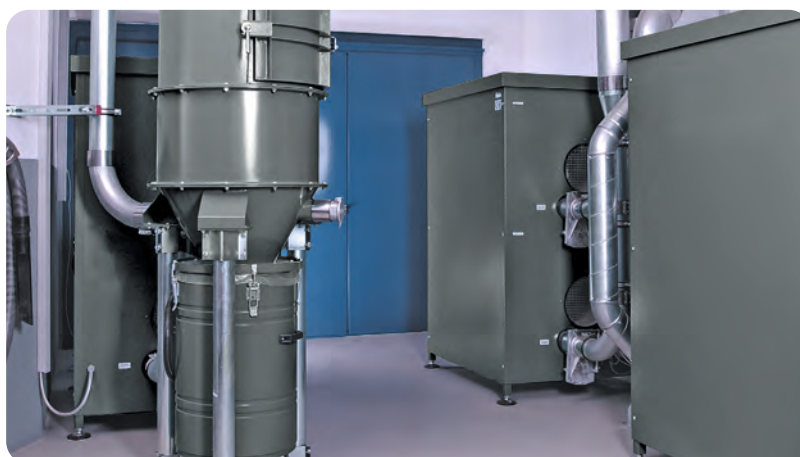
Zentrale Staubsaugereinheit mit zwei Seitenkanalverdichtern ausgestattet
