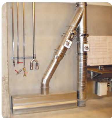
Stauberfassung durch spezielles Rohrleitungssystem
