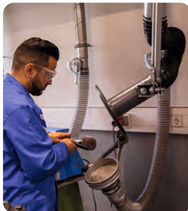
Absaugarm an Schleifarbeitsplatz
